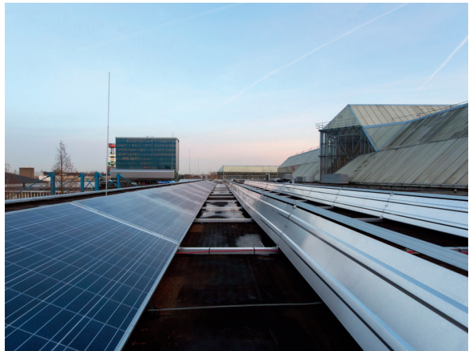
Zonnepanelen op dak hal 8
